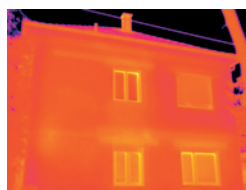
Wärmebild ohne testo ScaleAssist
